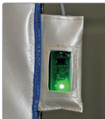
Status-LED signalisiert die korrekte Einbindung in den Sicherheitskreis!
